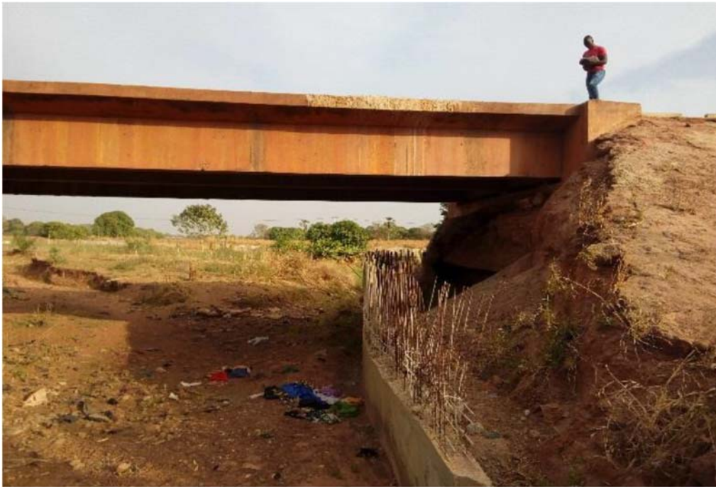
Photo 1 : Vue de la dégradation de la culée du pont à la sortie de Banfora au pk85+300, juillet 2023
